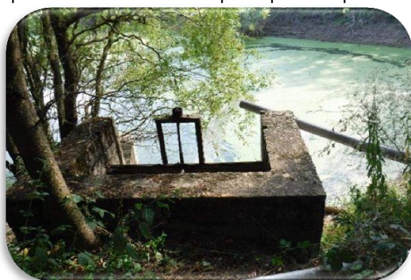
Ouvrage de vidange de l'étang - type Moine
